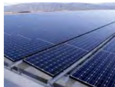
2011 年 伊那工場に太陽光発電設備を設置
