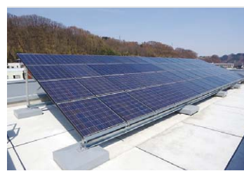
小海支店に導入した太陽光発電システム:支店の使用電力量の約18%を発電
